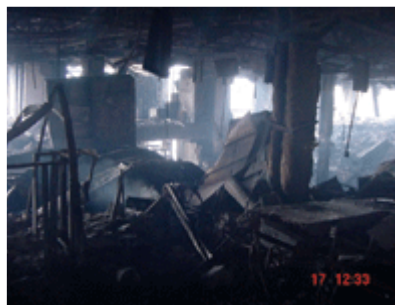
Los bomberos que se retiran del edificio, toman una foto de un colapso parcial en el piso 35
